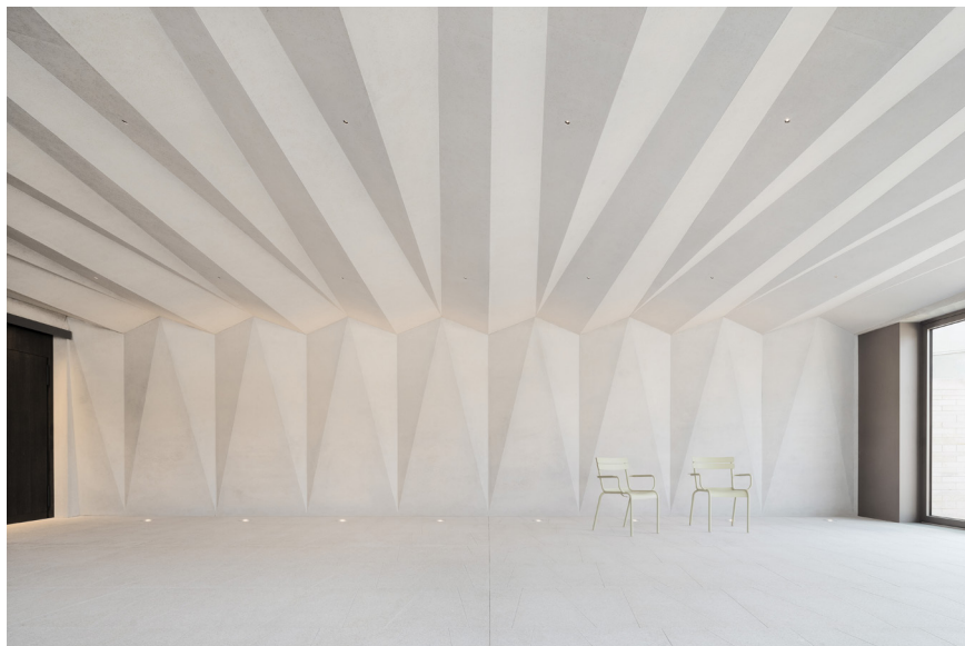
Sichtbeton-Faltungen in Sichtbeton (Bild: Brigida González)
