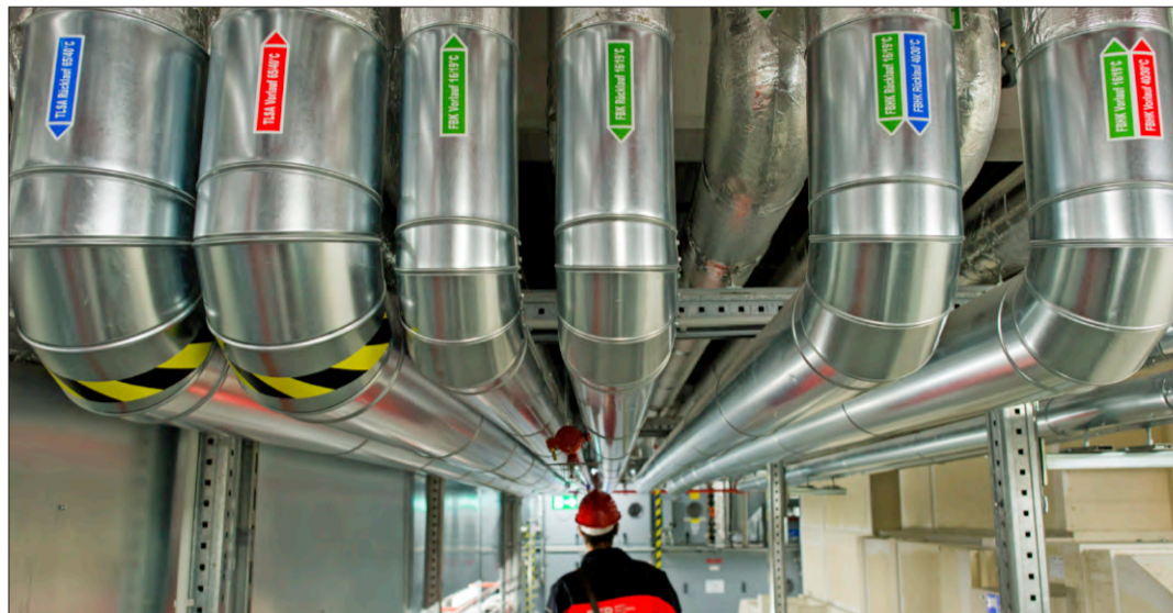
Prominentes Beispiel für eine unsachgemäße Planung im Bereich des Brandschutzes: die nicht funktionsfähige Entrauchungsanlage des Flughafens Berlin-Brandenburg FOTO: PATRICK PLEUL
