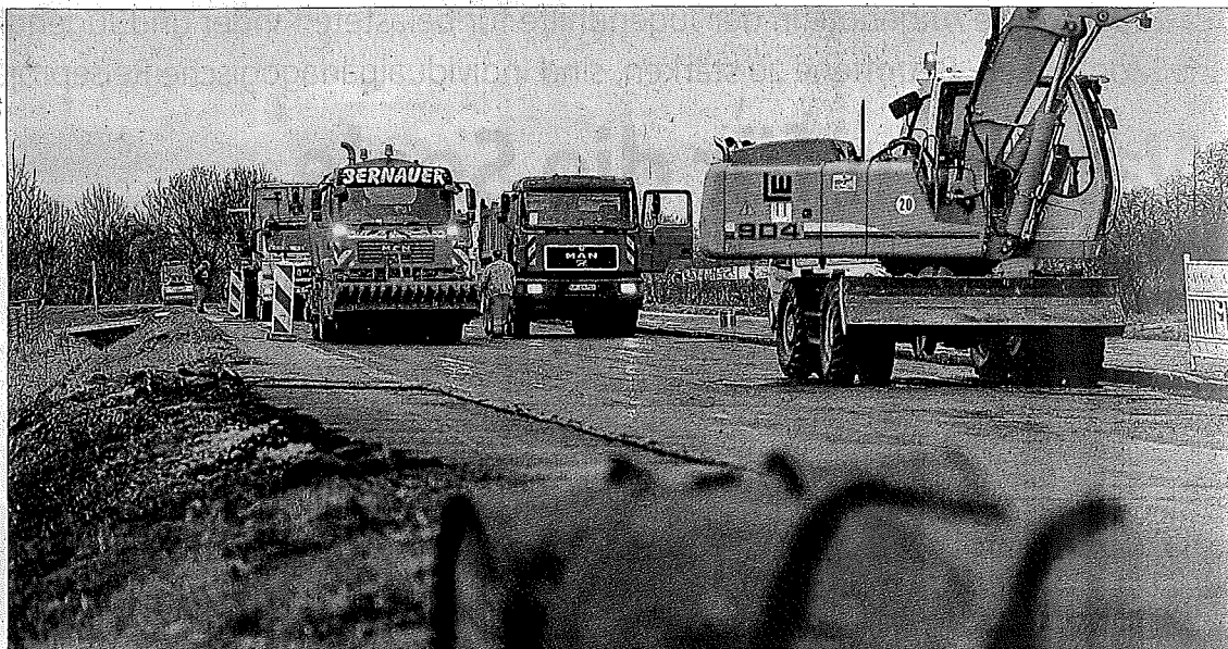
Bauarbeiten im Landkreis Göppingen: Um nicht abgerufene Bundesmittel ist ein heftiger Streit entbrannt.
